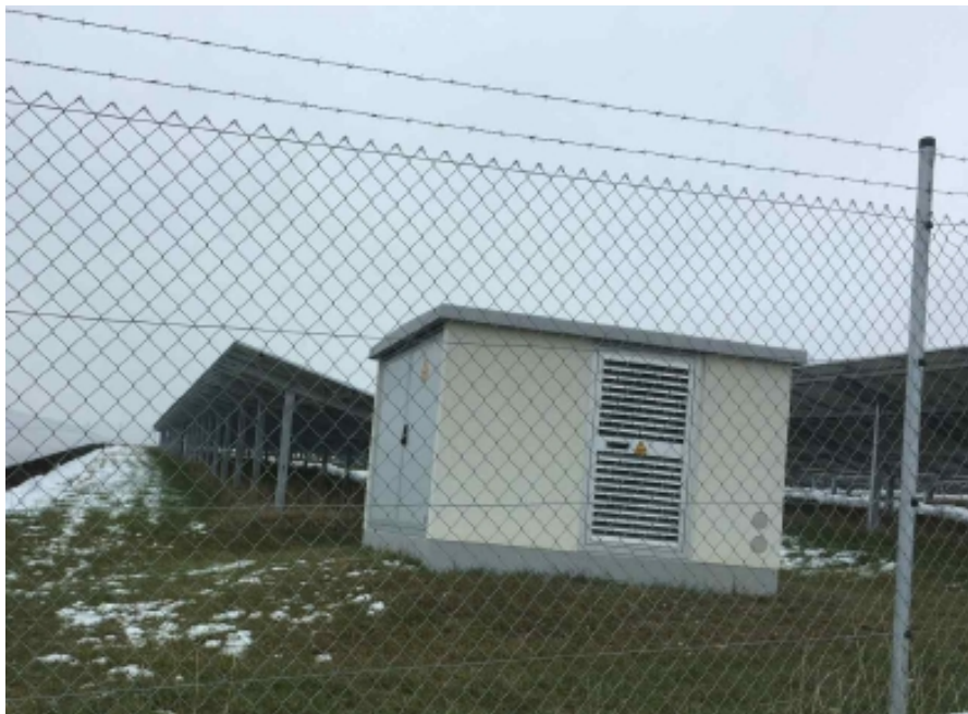
Die Trafostation einer gleichartigen Photovoltaik-Freiflächenanlage. Der Trafo ist deutlich niedriger und schmaler als die Modultische. Die Wechselrichter und Schaltkästen werden nicht sichtbar unter den Modultischen montiert.
